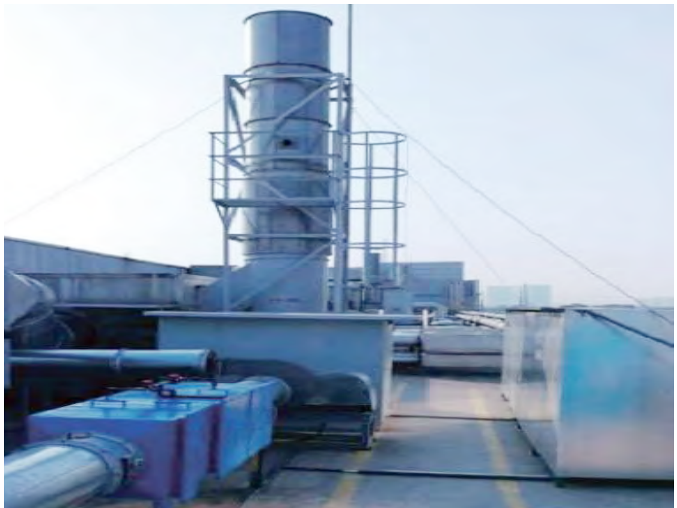
上海法雷奥汽车电器系统有限公司生产工段有机废气处理示范工程 (Q=1000m 2 /h)
