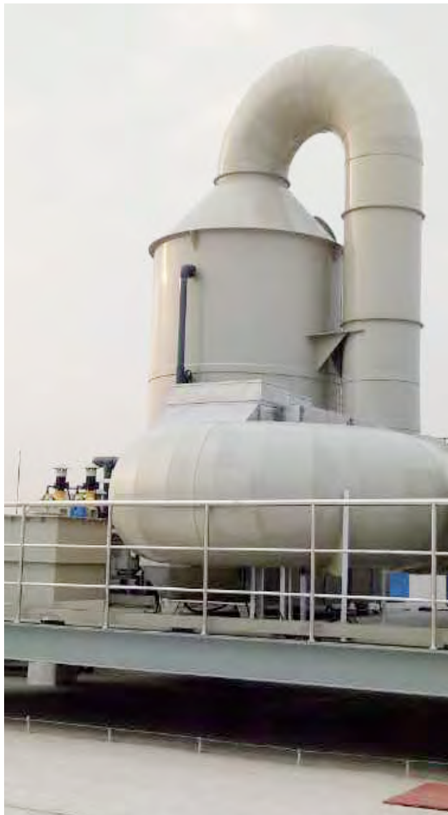
晟碟半导体(上海)有限公司除臭工程 Q=80000\text{m}^3/\text{h}
