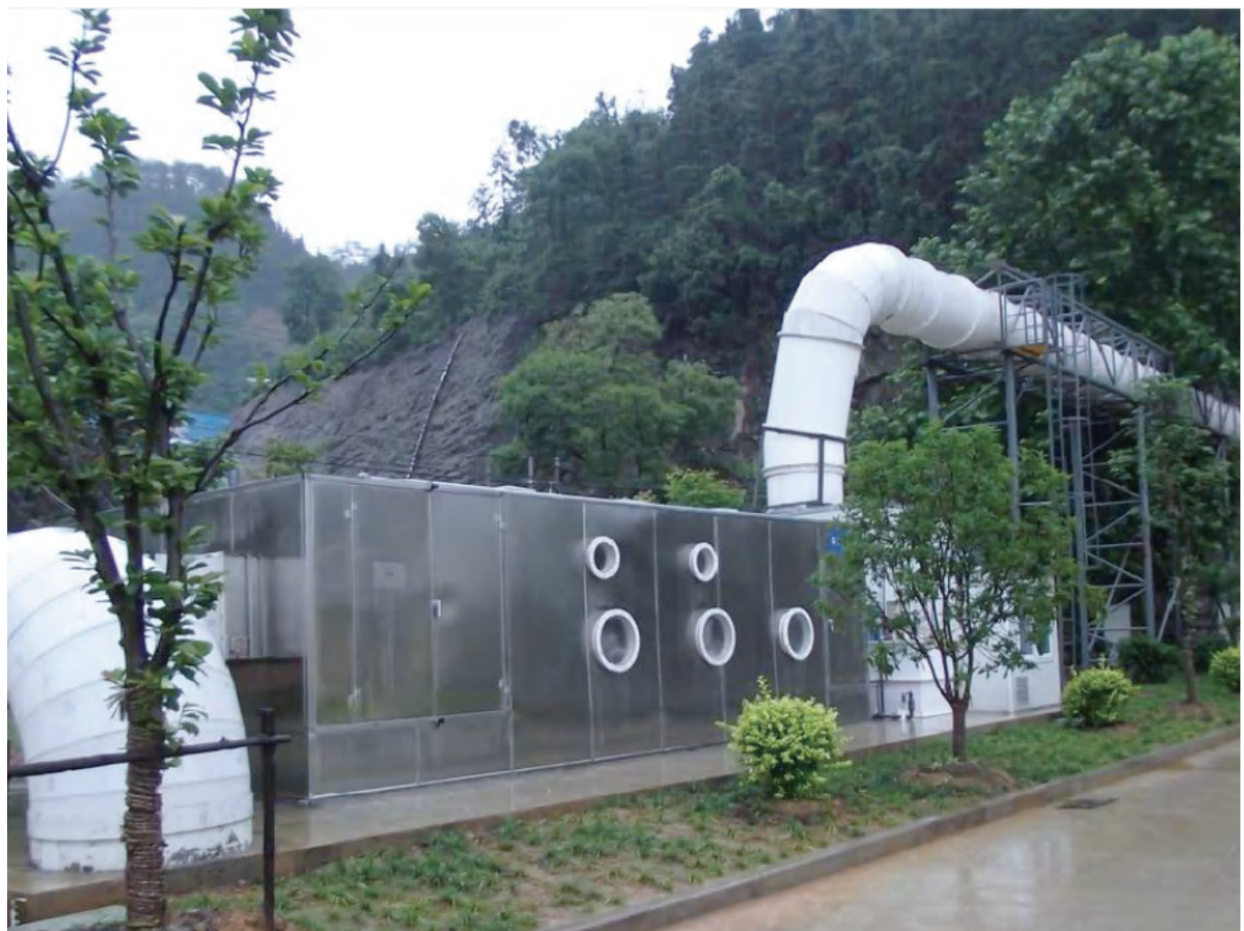
浙江淳安县城西污水处理厂除臭工程 (工艺: 活性氧离子 + 化学洗涤净化) Q=50000\text{m}^3/\text{h}
