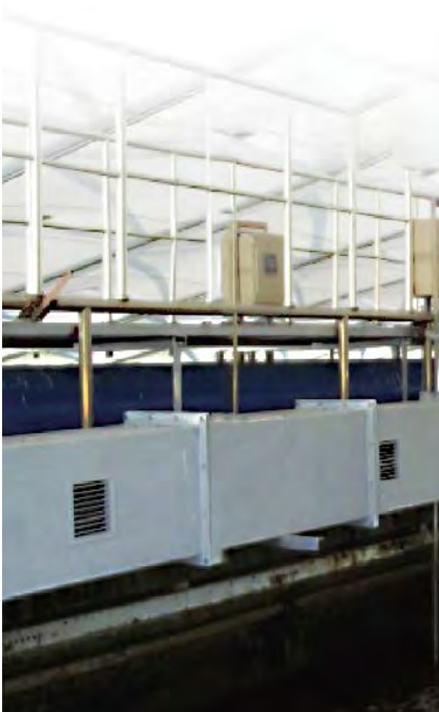
浙江宁海城北污水厂除臭工程收集风管与加盖
