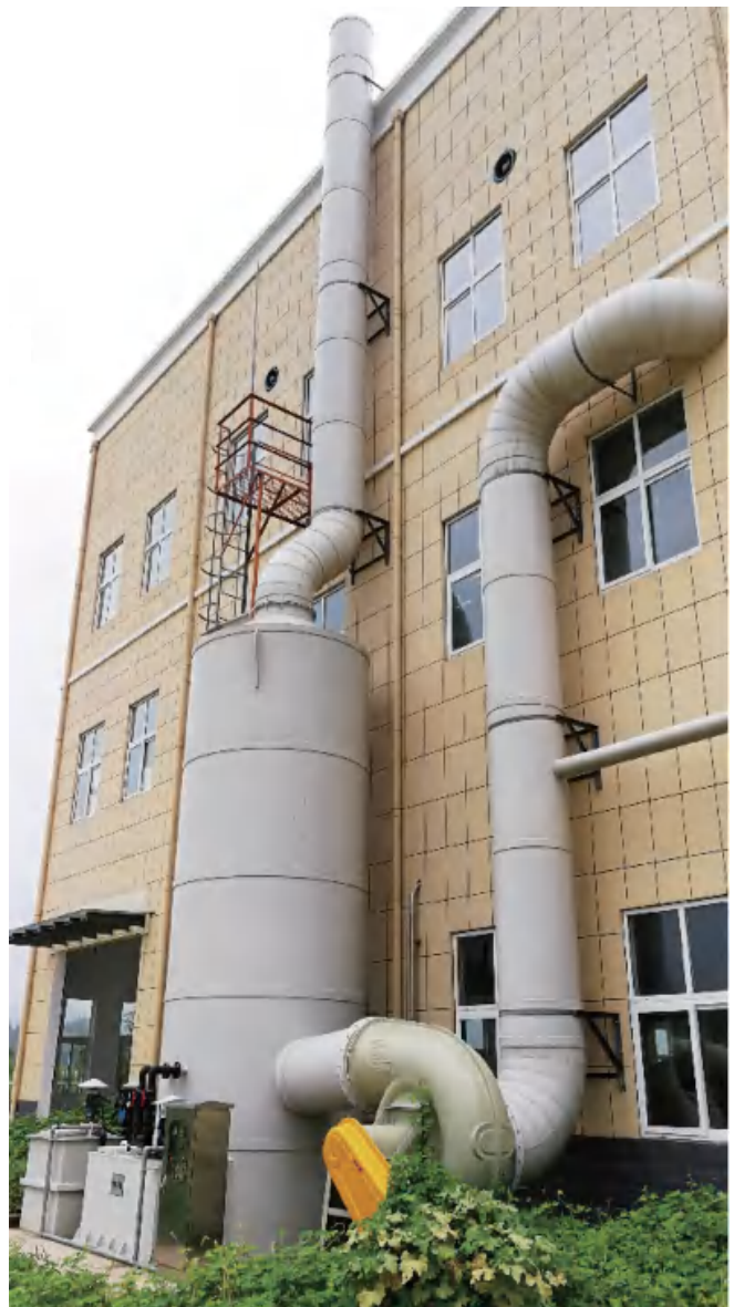
安徽泾县污水处理厂污泥车间除臭工程 Q=20000\text{m}^3/\text{h}
