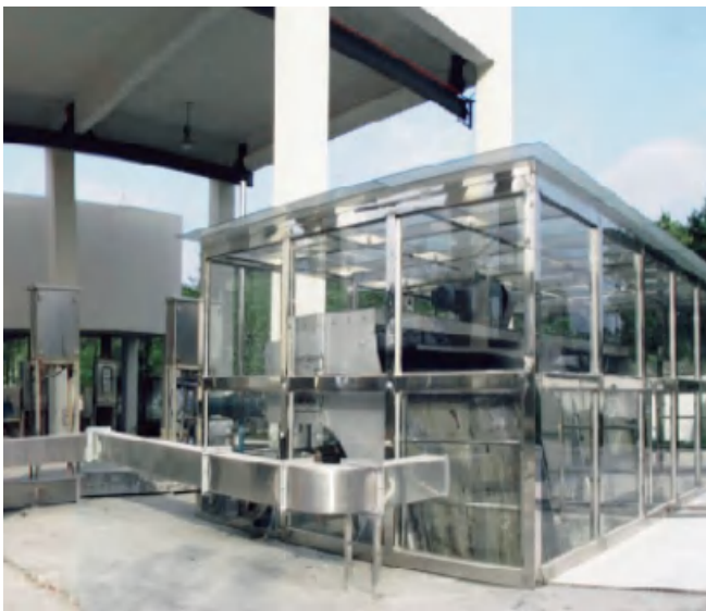
温州西片污水处理厂除臭工程离子除臭 Q=10000\text{m}^3/\text{h}
