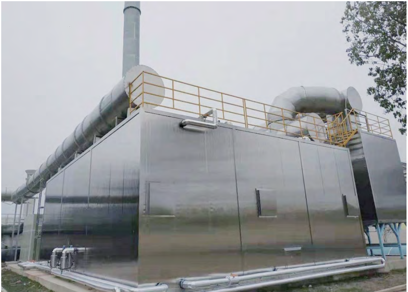
上海石洞口污水处理厂提标改造除臭工程 ( Q=145000\text{m}^3/\text{h} )
