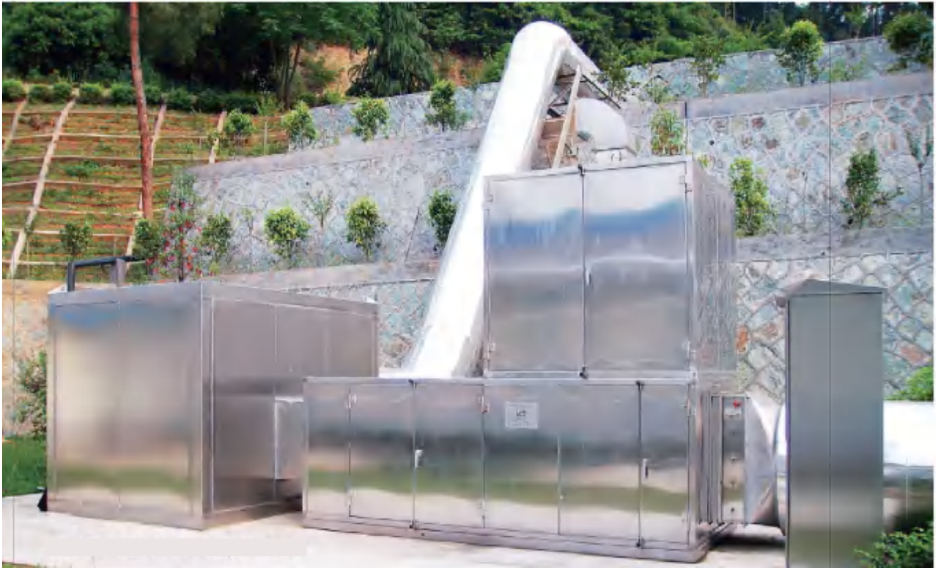
浙江千岛湖南山污水厂离子除臭 Q=35000\text{m}^3/\text{h}
