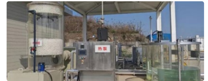
蒸汽热泵在氢能中试项目现场
